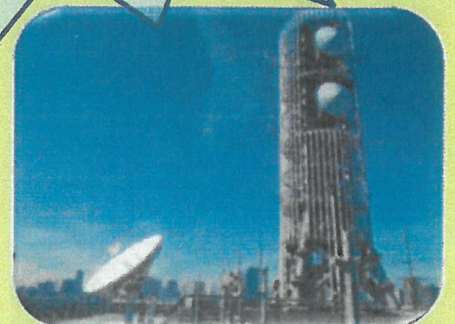
通信設備(警察本部屋上)
