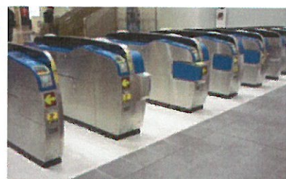
駅機械システム
