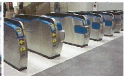
駅機械システム
