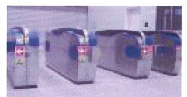
駅機械システム
